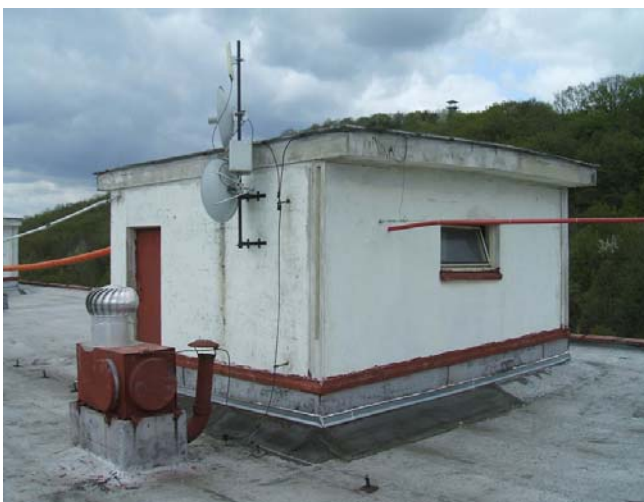
Strojovna výtahu - původní
