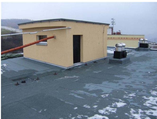
Strojovna výtahu – po rekonstrukci
