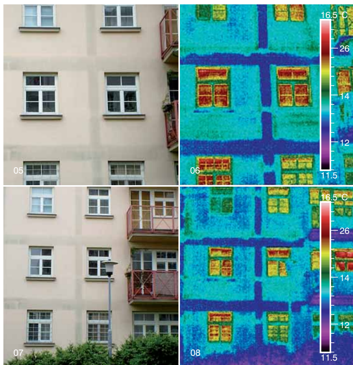
05, 07 | Prokreslení nosného skeletu na povrchu fasády zašpiněním 06, 08 | Termovize potvrzuje nižší teploty zašpiněných povrchů zatepleného nosného skeletu
